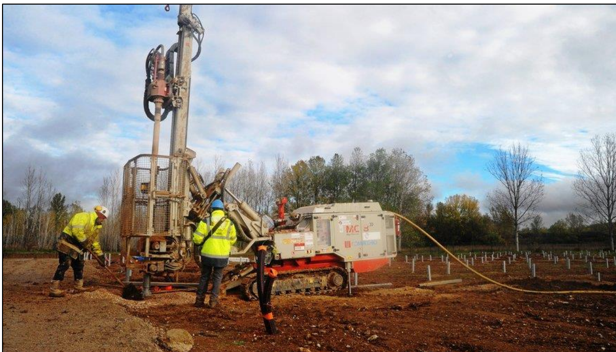
Projet photovoltaïque au sol de 3,04 MWc réalisé par le CNR dans l'Ain sur Villebois.
