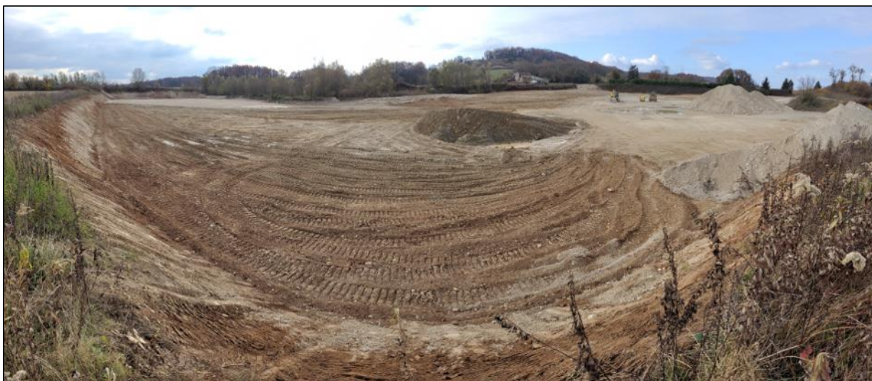
Projet photovoltaïque au sol de 29,9 MW réalisé par EDF en Bourgogne Franche-Comté sur Nièvre.
